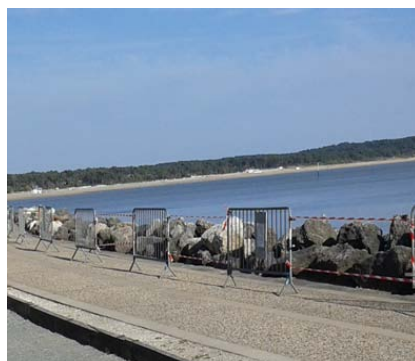
La promenade elle s'effondre
